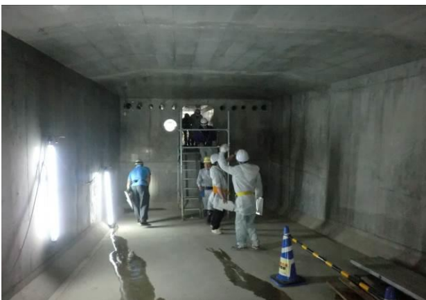
箱桁橋の中（P3 橋脚部付近：上の小さな孔が外ケーブルの通る孔）
