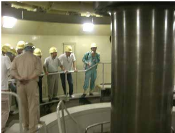
地下3階 水車室1号機の水車室内部
