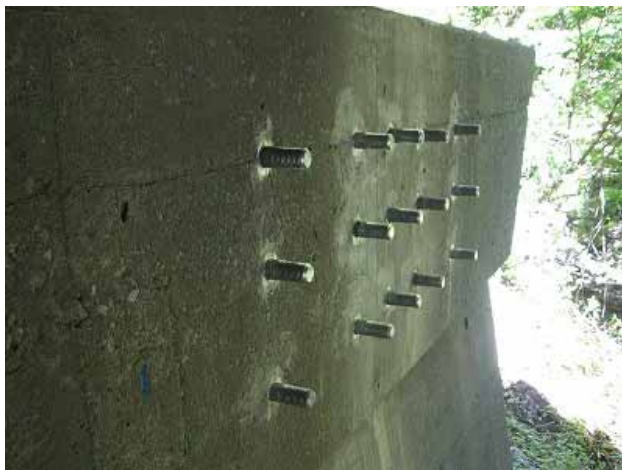
施工後に残されている支承取替時のアンカー
