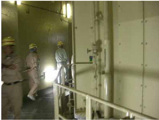
地下2階 1号機の発電機室内部
