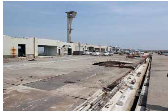
関上魚市場は、一部の壁を残して屋根も壁も消えてしまった
