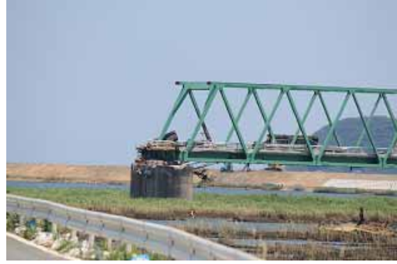
左岸側の2径間が流された新北上大橋
