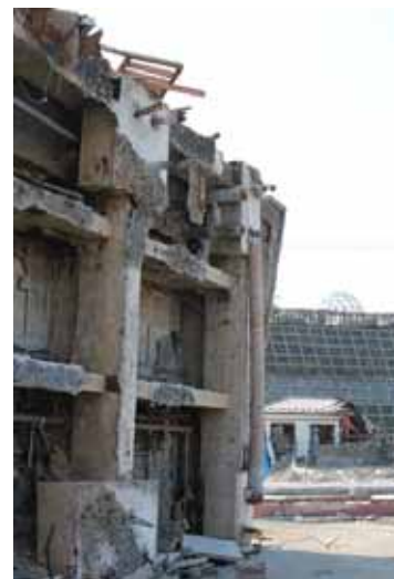
16本のコンクリートパイル打設されていたビルも倒壊
