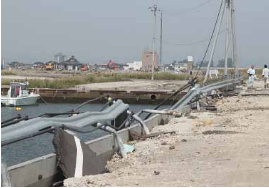
プレキャストL型擁壁と折れ曲がったガードレール。
