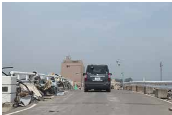
右側は仮設用防護柵であるが、左側の高欄は残っている。
