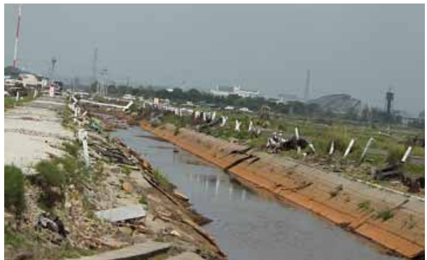
ガードレールのビームは全て流されて支柱のみ
