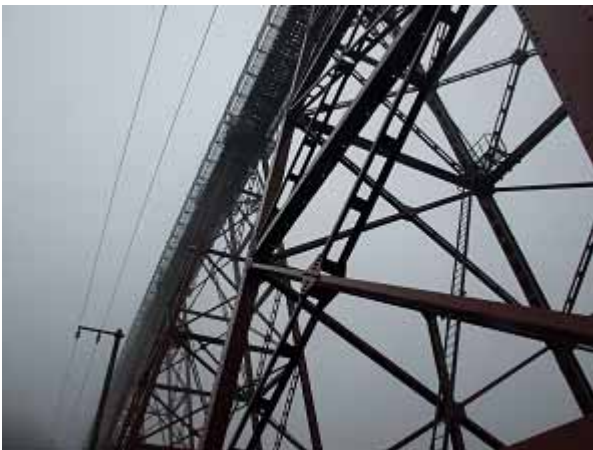
維持管理用の昇降設備
