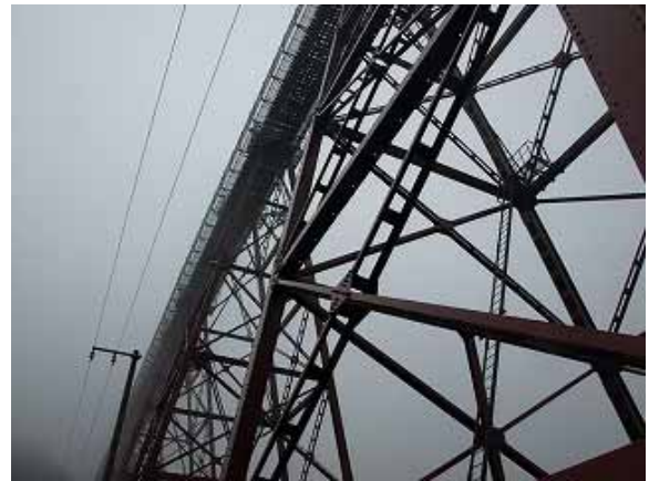
維持管理用の昇降設備
