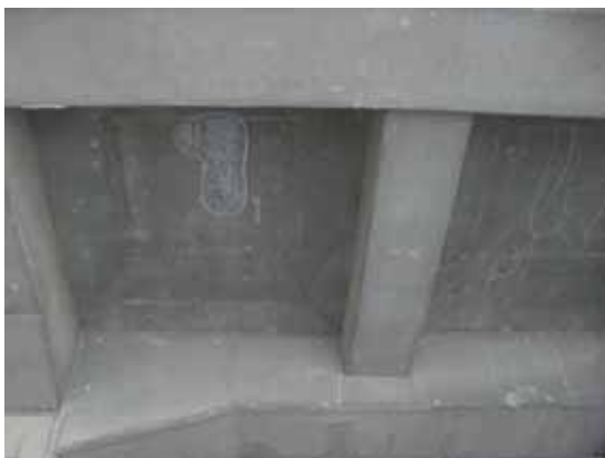
道路上の補修・点検状態
