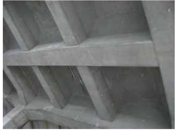
コンクリート剥落
