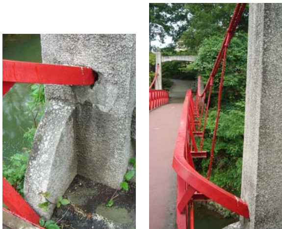
写真 4-1 手摺りのアングルが主塔コンクリートから外れかけている（左写真）
