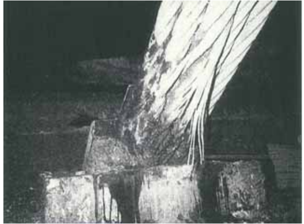
写真 11：ケーブルアンカーの破損状況
