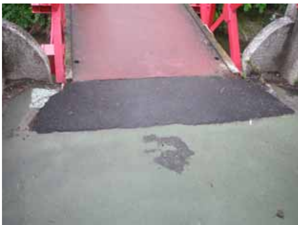
写真 4：左岸側路面の段差
