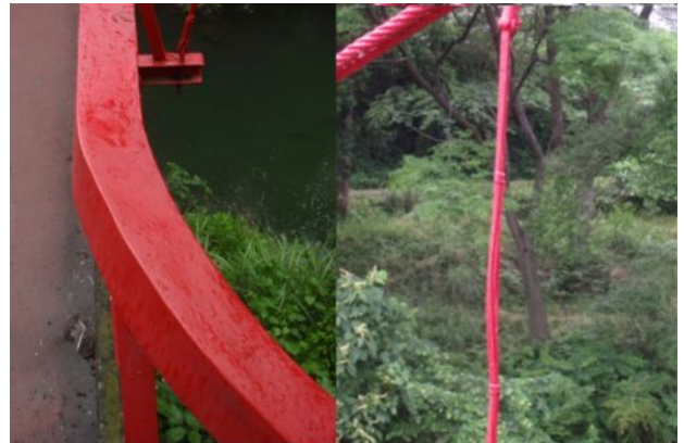
図4 左)高欄の変形 右)吊り材のたわみ
