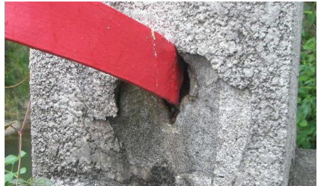
図3 高欄定着部の破損状況
